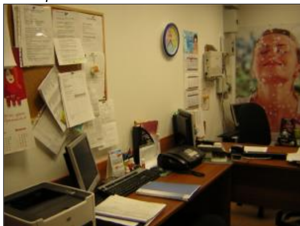
Фото 3 Состояние внутренней отделки офисных помещений
